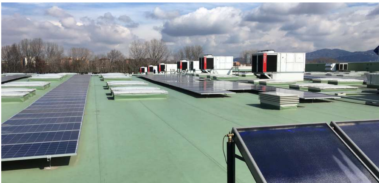
Esempio di posizionamento su tetto piano di pannelli fotovoltaici e collettori solari performanti
